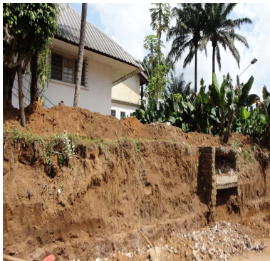
Le mur de la maison de Cocody s'est écroulé suite à une forte pluie
